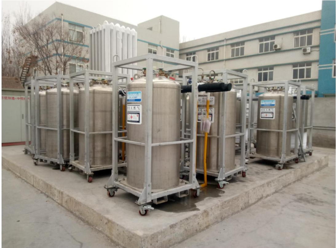
液化天然气气化站
